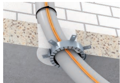
Cauruļu pasta iekārta ar 2 paralēliem kabeļiem
