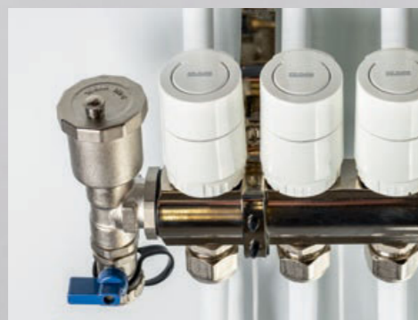
Telpas termostats kontrolē arī izpildmehānismus (230 V), kas ir uzstādīti apkures loka sadalītājā.
