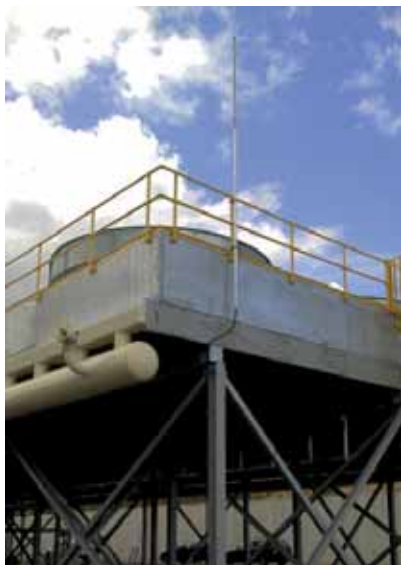
Izolēta novadišanas sistēma sprādzienbīstamā zonā
