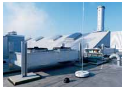
Izolēta zibensaizsardzība uz jumta konstrukcijām
