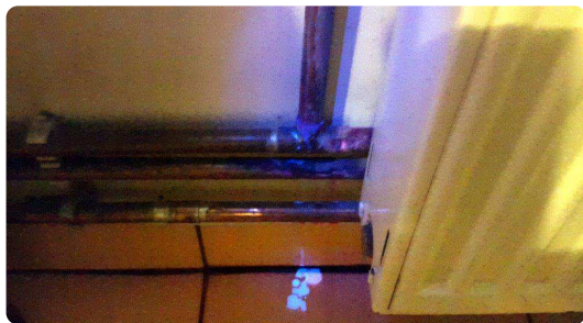
Siltumnesēja noplūdes vieta apkures sistēmā apgaismota ar UV lukturi Место утечки теплоносителя в системе отопления подсвеченное УФ фонариком
